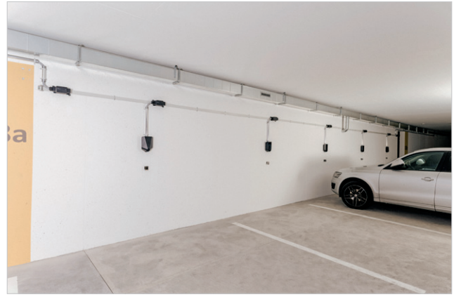
Abb. 52: Skalierbare Installation in einer Tiefgarage mit easee Stationen basierend auf Rückplatten (Quelle: ewz).
