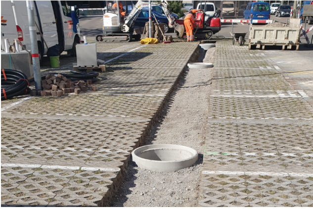
Abb. 65: Vorbereitung für die künftige Elektrifizierung (Quelle: Siemens).
