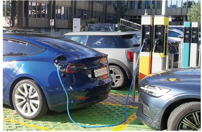
Abb. 66: SICHARGE CC AC22 mit zwei Steckdosen Typ 2 (Quelle: Siemens).
