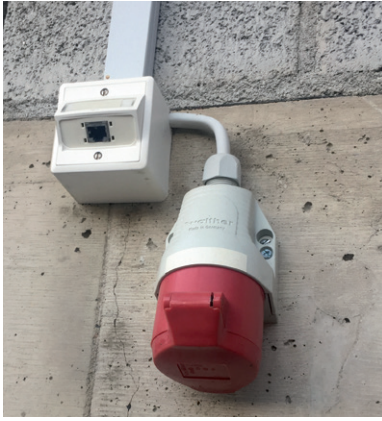
Abb. 48: Vorrichtung für eine spätere Ladestation mit CEE-Stecker und LAN-Verbindung. Optimale Lösung für die Einfügung der Ladestation in ein Lademanagement- und/oder Zutritts- und Bezahlssystem.
