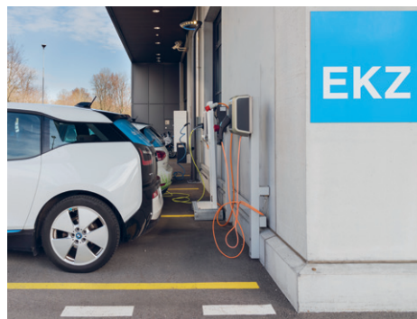
Abb. 37: Ladestation für normales/beschleunigtes Laden für Besucherparkplätze im Aussenbereich (Quelle: EKZ).
